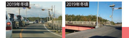
予算を獲得し、現在も交差点改修工事が 行われています
